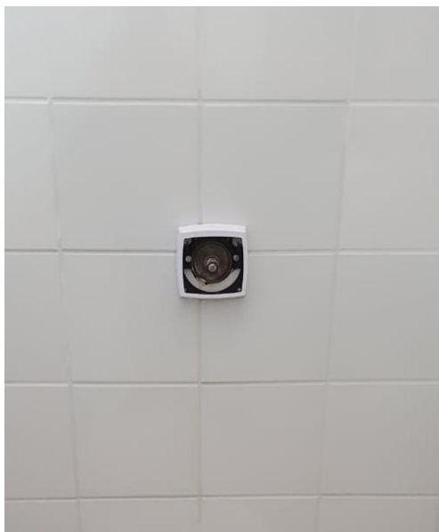
Ausência do acabamento da válvula de descarga (banheiro masc.)
