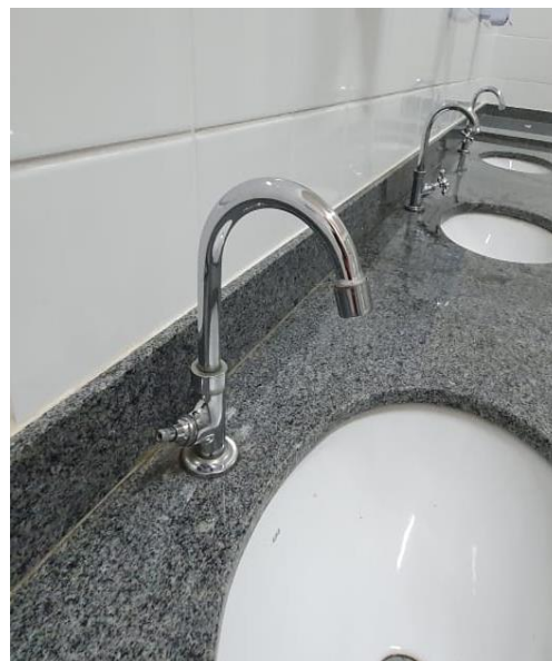
Torneira danificada (banheiro fem.)
