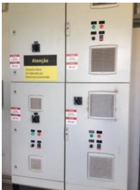
Foto 05 – Painel das bombas
