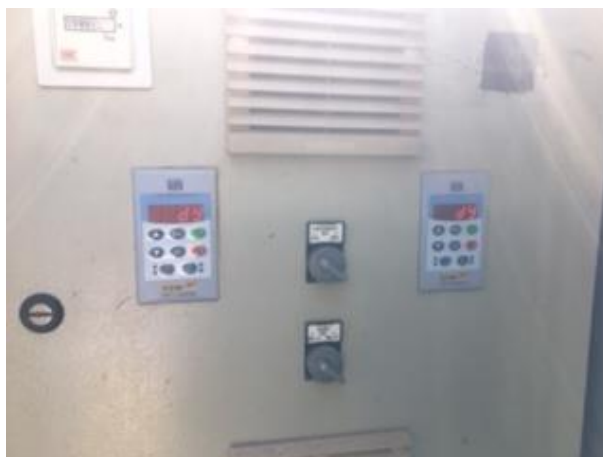
Foto 05 – Painel das bombas
