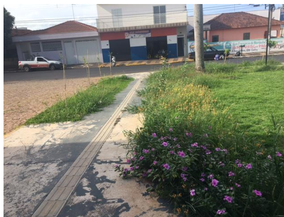
Foto 4 – Não conformidade constatada
