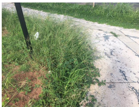
Foto 2 – Não conformidade constatada
